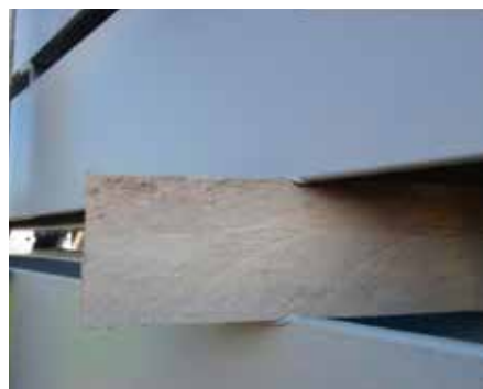
Insnijding coating door oplegging stophout (2).
