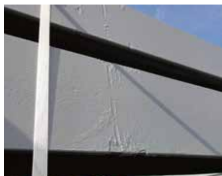
Beschadiging door kantelen tijdens spuiten.
