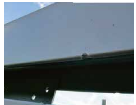
Insnijding door oplegging juk bij spuiten (kantelen).
