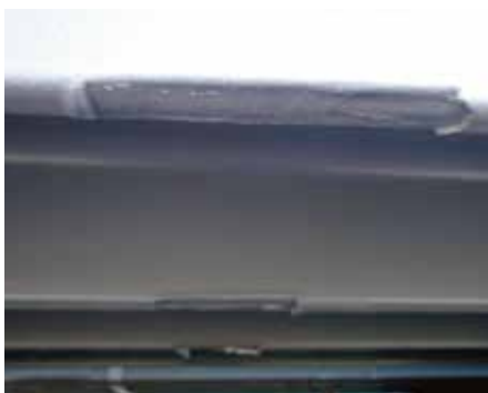
Insnijding coating door oplegging stophout (1).
